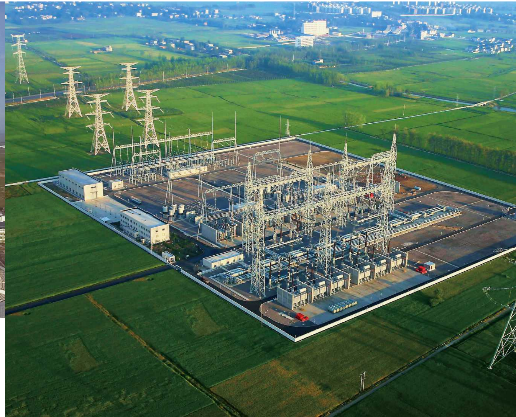
皖电东送淮南至上海特高压交流工程1000kV淮南变电站
