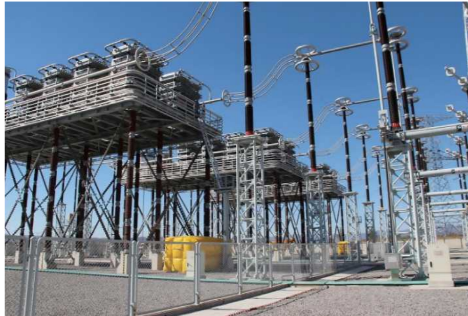
世界上首套投入运行的1000kV串补装置-晋东南站串补装置
