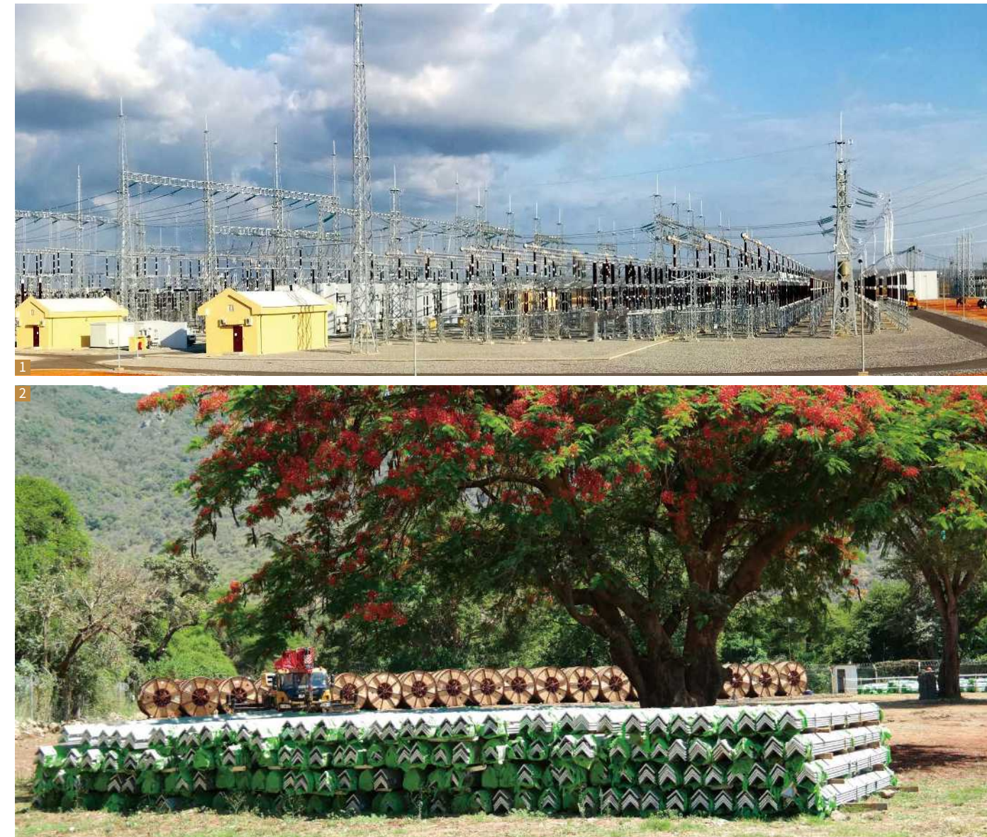
1、安哥拉国内至今最大的输变电项目-安哥拉SK输变电站项目 400kV变电站 2、肯尼亚LOIYANGALANI-SUSWA 400kV输电线路项目
