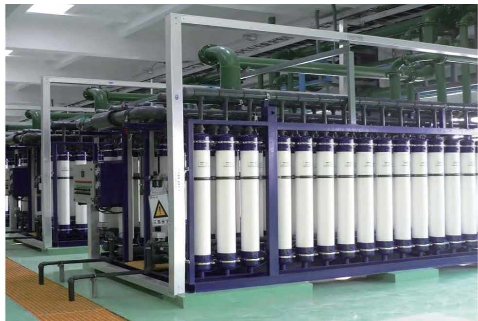
河北大唐国际王滩电厂工程海水淡化系统
