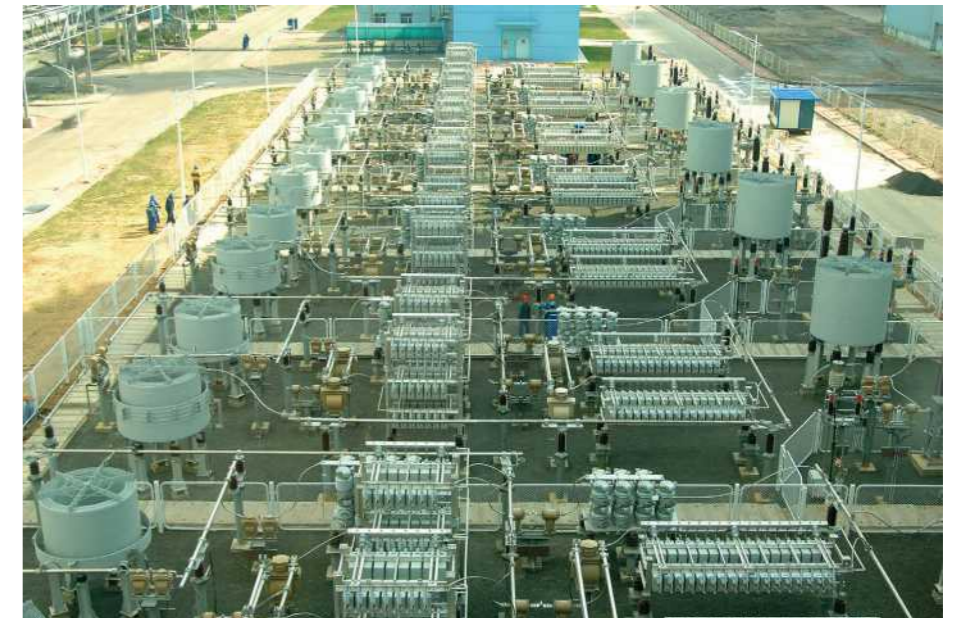
大唐托克托电厂阻塞滤波器全景图
