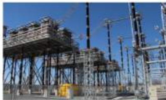
世界上首套投入运行的1000kV串补装置-晋东南站串补
