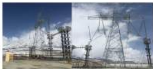
高海拔特高压直流试验基地试验线塔
