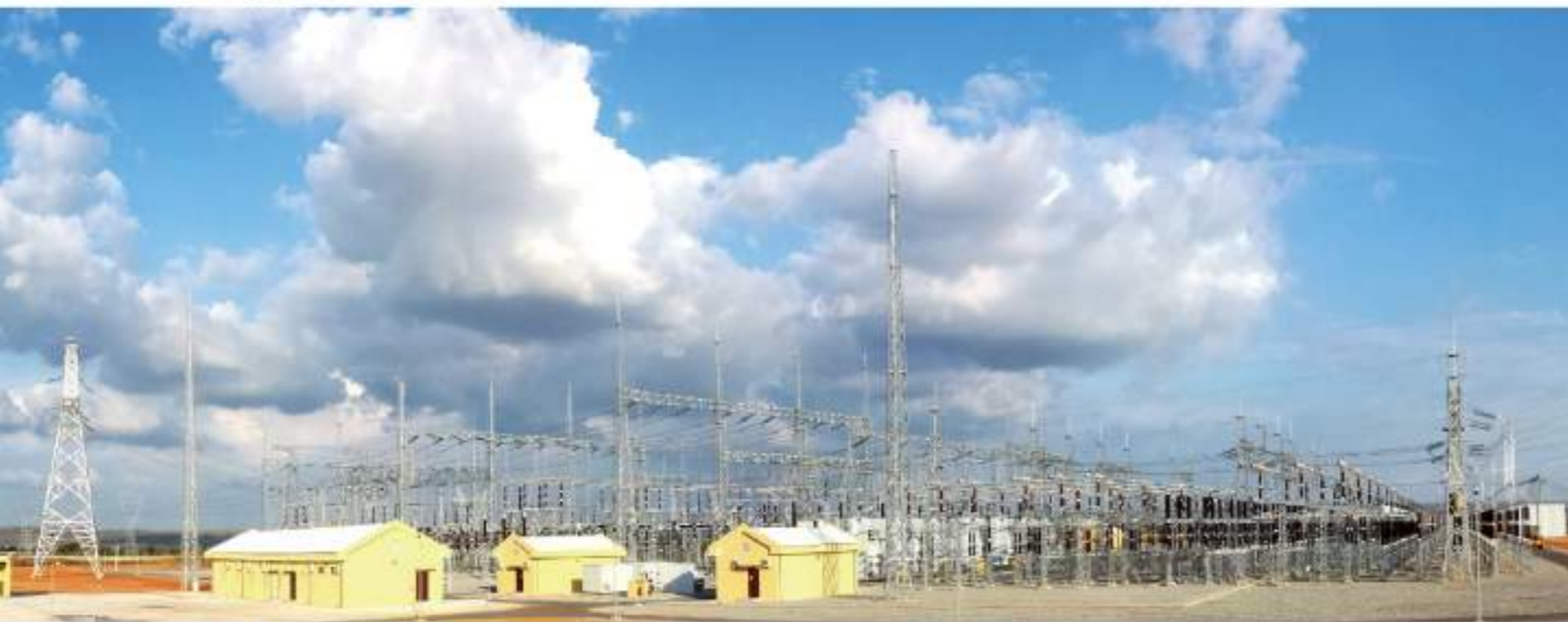
CATETE 400kV变电站
