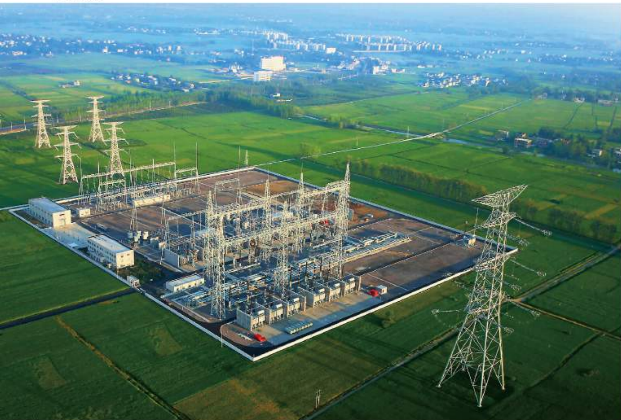
淮南1000kV变电站
