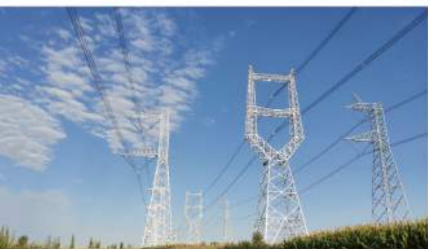
±1100kV输电线路
