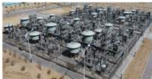
托克托电厂SSR治理设备区
