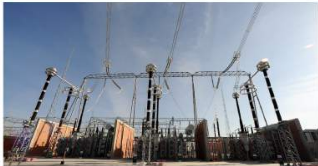
晋东南1000kV变电站主要设备
