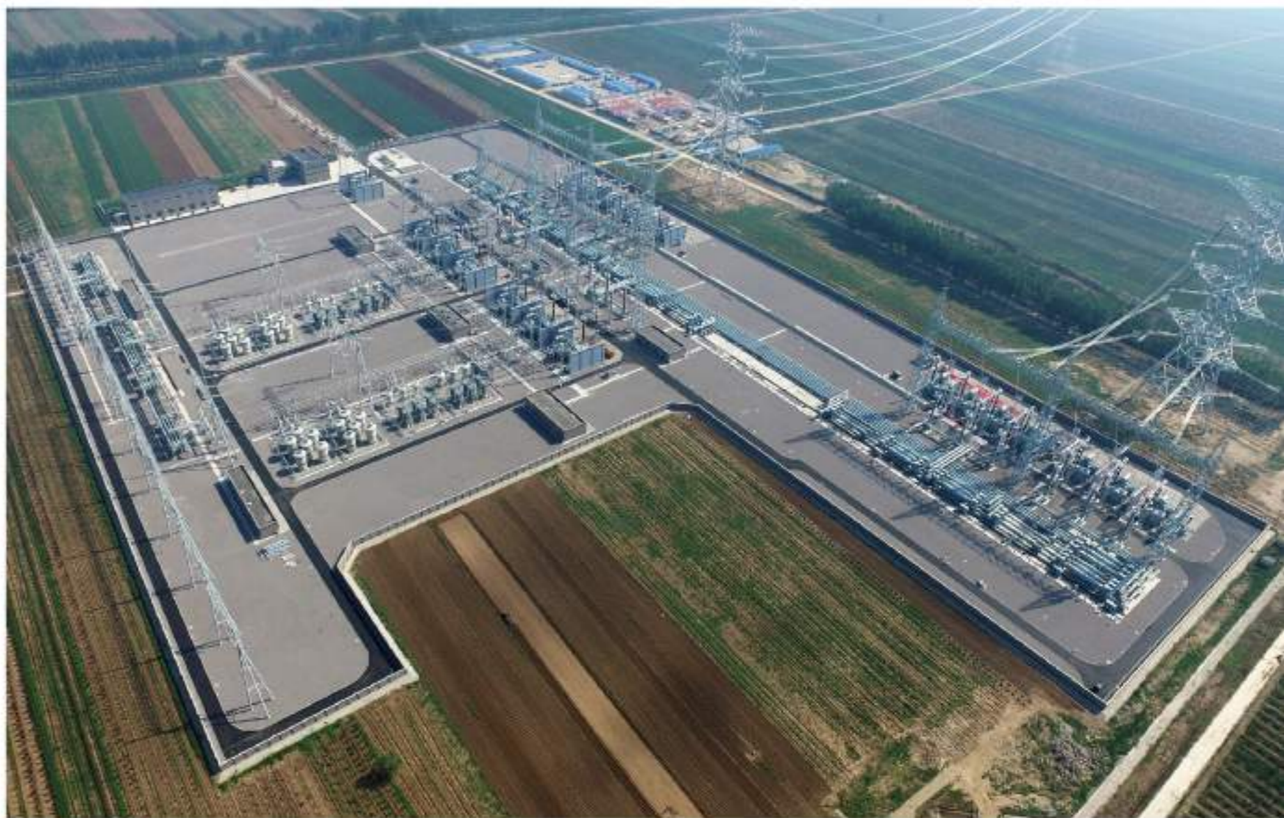
北京东1000kV变电站
