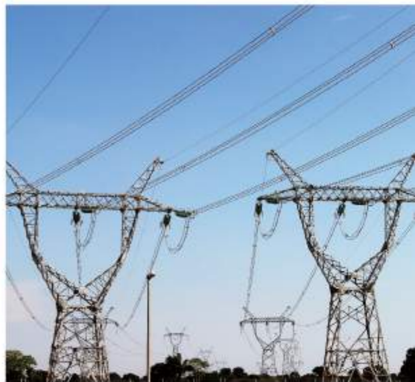
400kV输电线路二
