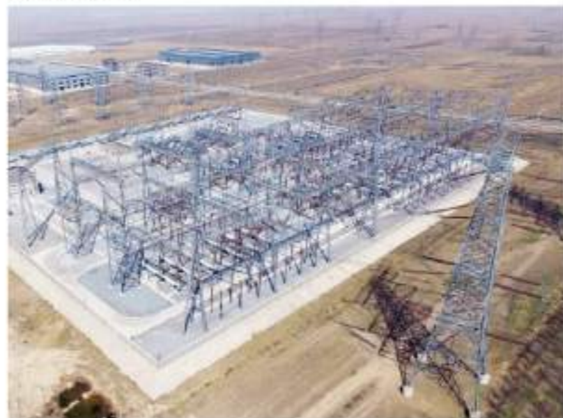
天津静海500kV变电站
