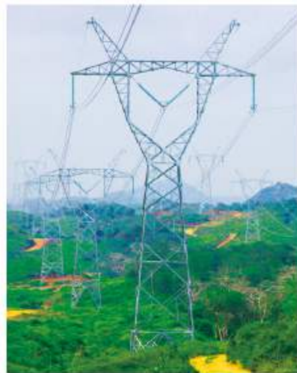
400kV输电线路一
