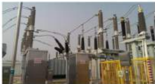
旺村220kV变电站
