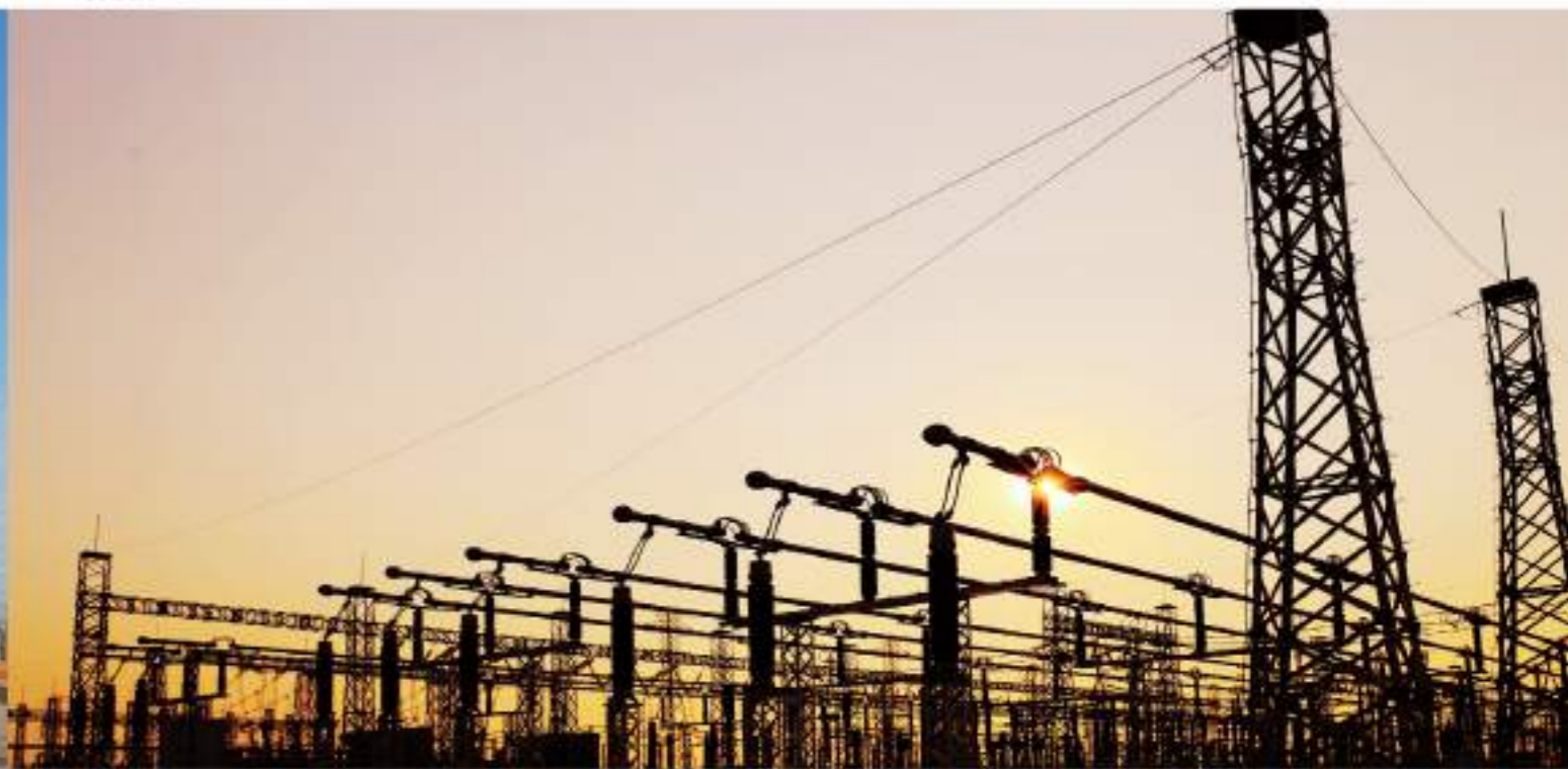
400kV变电站设备区
