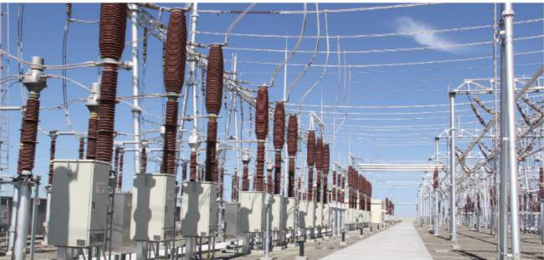
三塘湖750kV变电站
