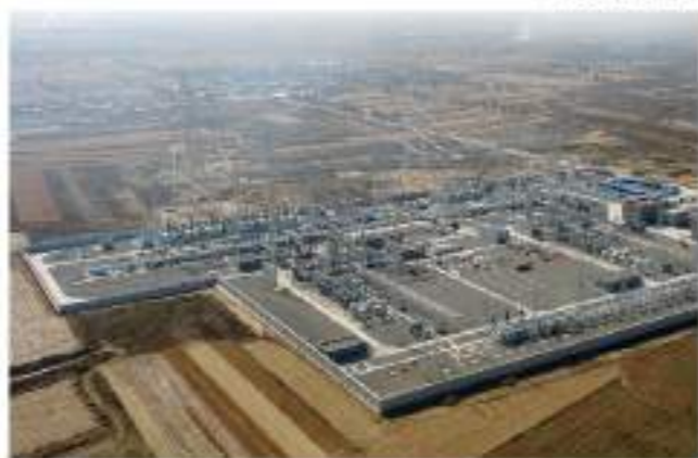
蒙西1000kV变电站
