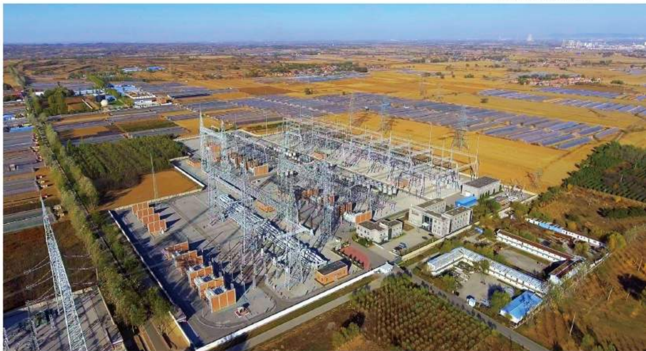
晋东南1000kV变电站及串补设备区
