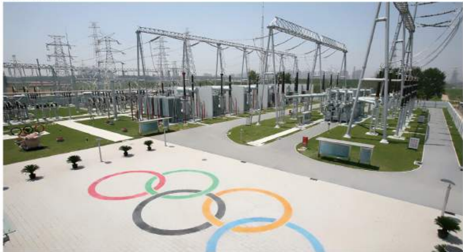
城北500kV变电站奥运广场
