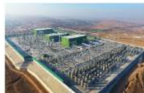
输电工程竣工环保验收
