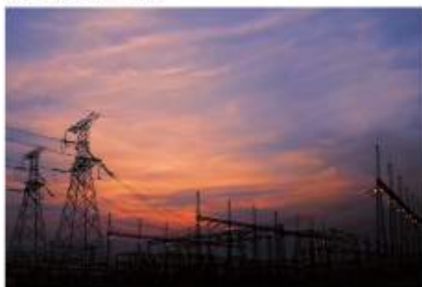
安哥拉KAPARYA400kV变电站
