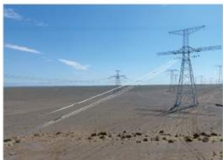
±1100kV输电线路
