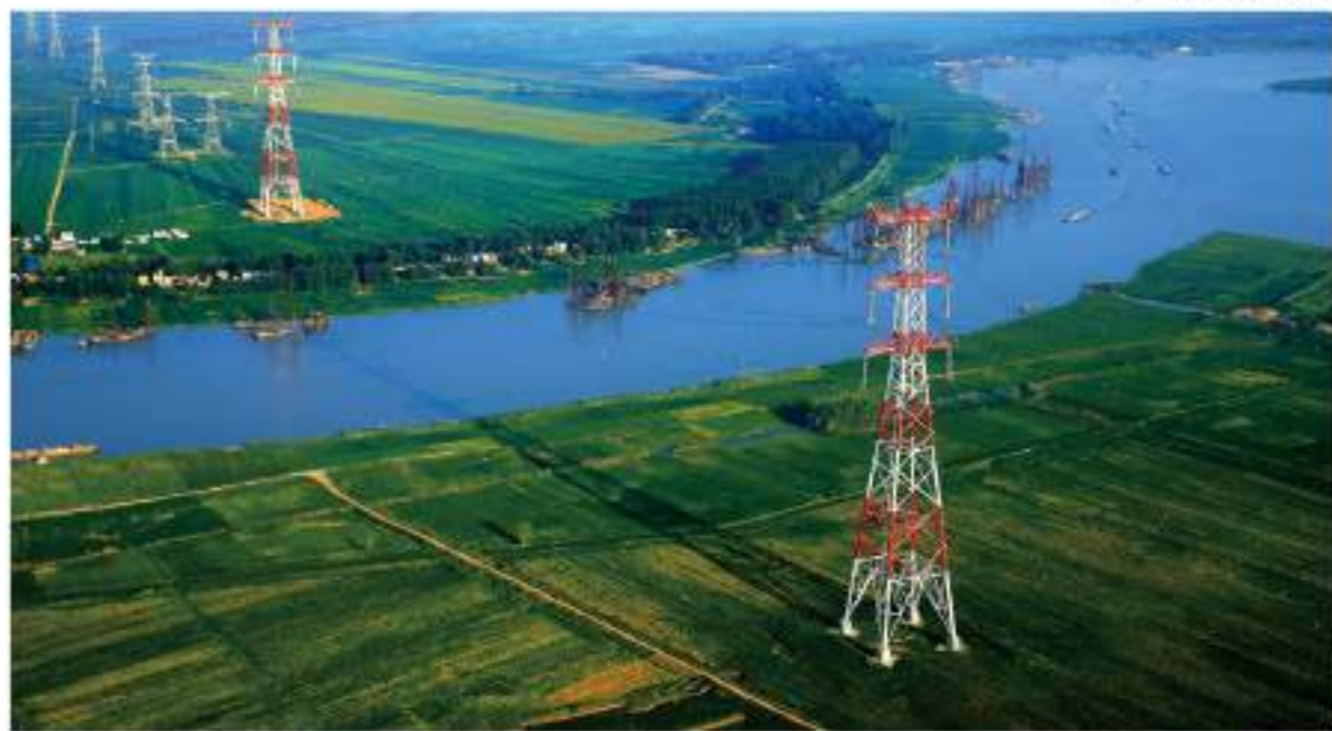
淮河1000kV线路大跨越
