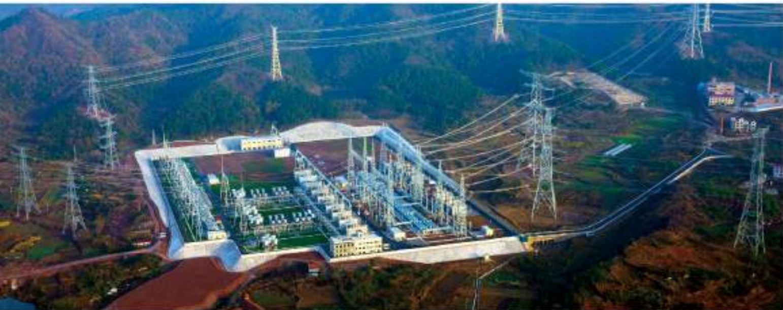
浙中1000kV变电站
