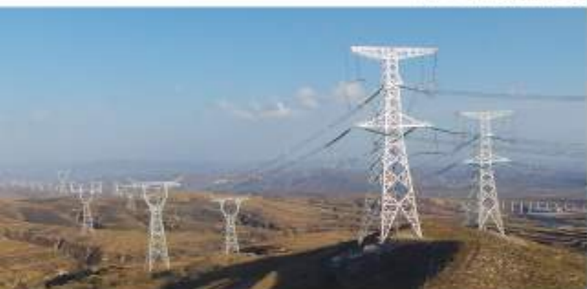
蒙西~天津南1000kV输电线路
