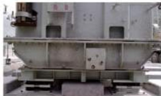
1000kV主变压器隔离墩框架
