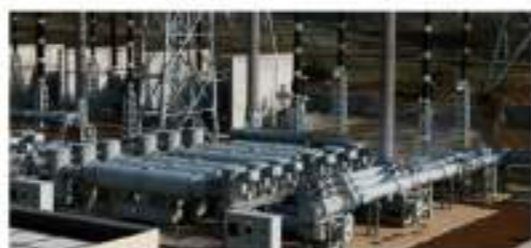
1100kV GIS断路器折叠布置实景图
