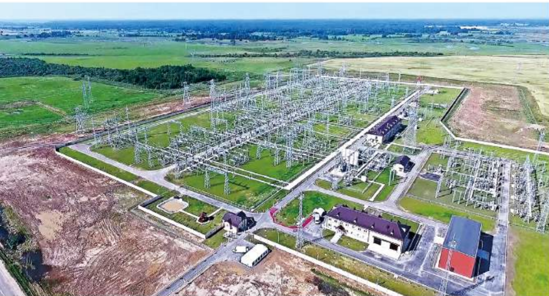
白俄罗斯核电送出及电力联网项目和明斯克北方330千伏变电站改造项目
