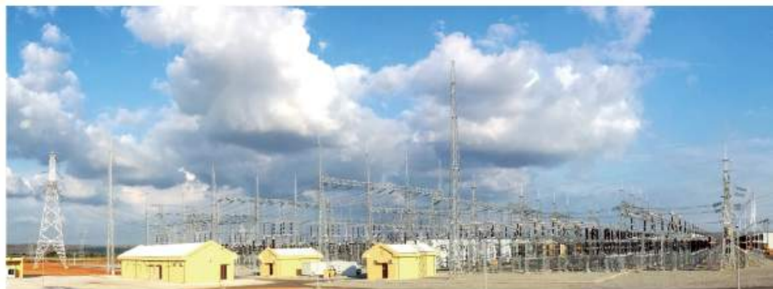
安哥拉CATETE 400KV变电站
