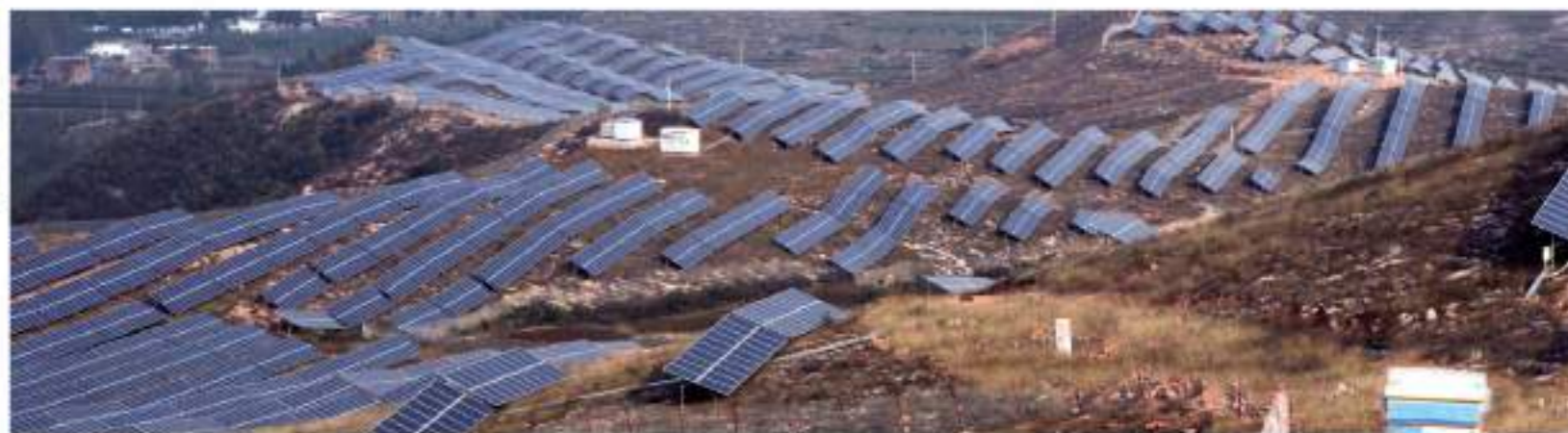
光伏电站发电项目
