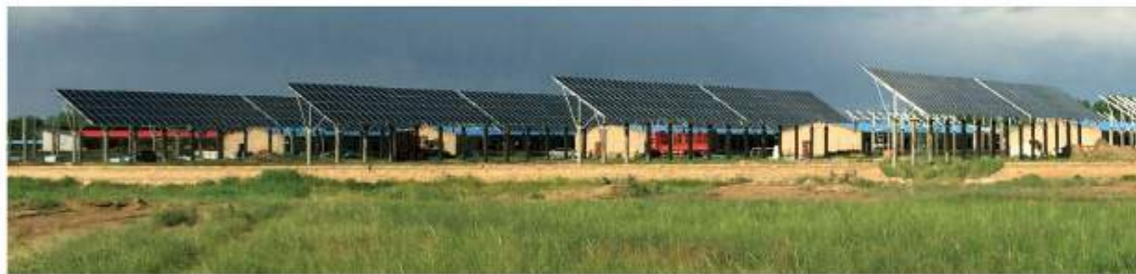
山西泽电王坪热力怀仁65MW分布式光伏发电项目
