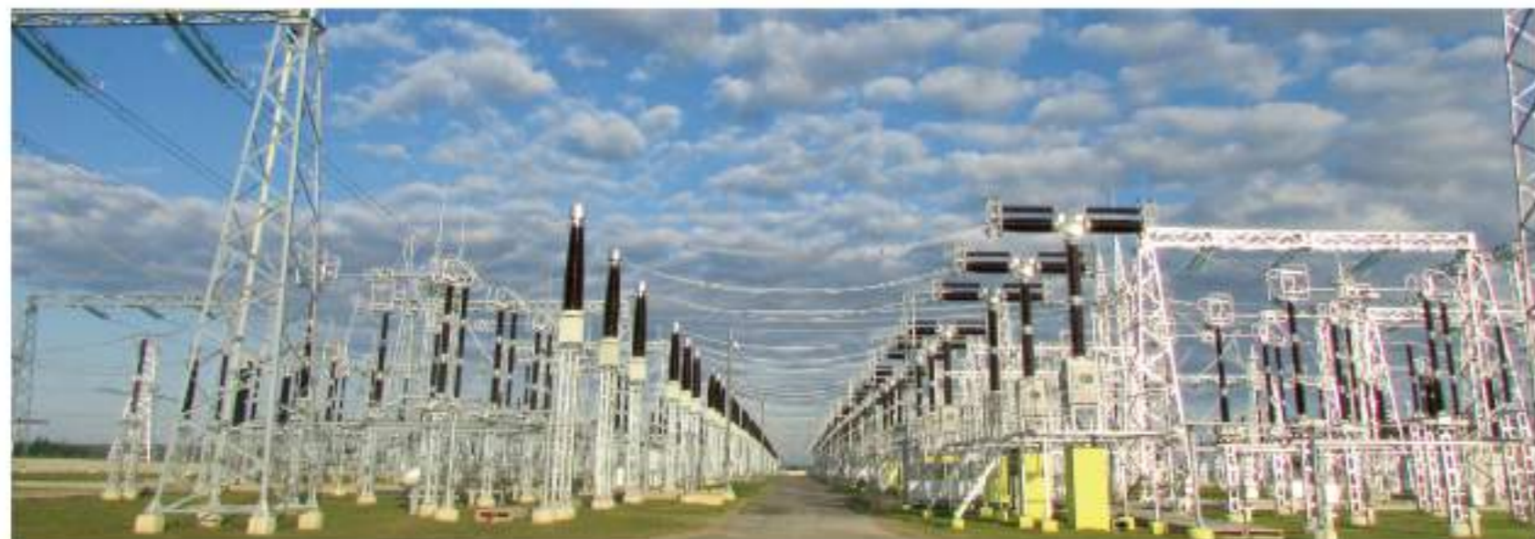
白俄罗斯核电输出及电力联网项目波斯塔维330KV变电站
