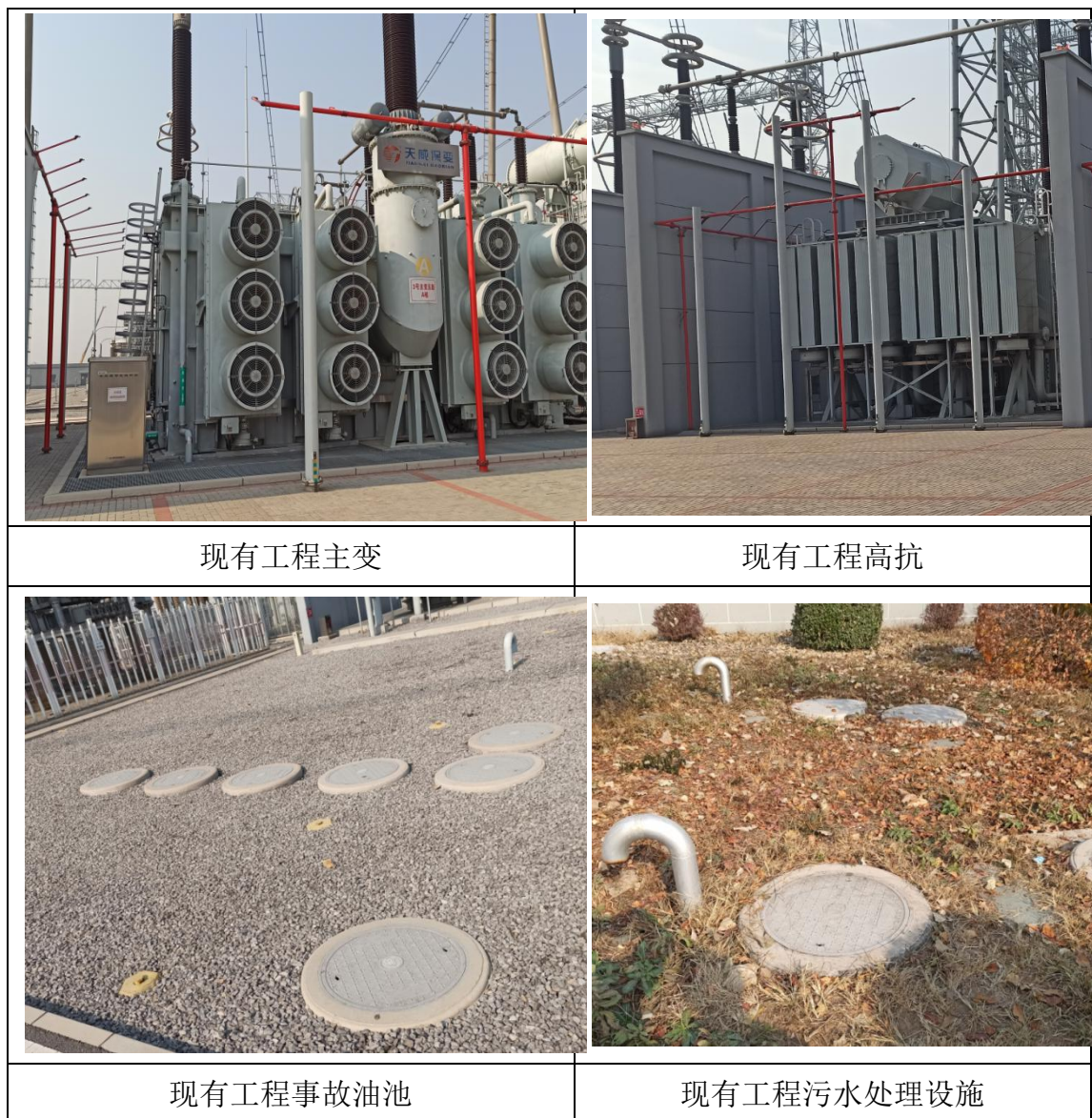
图 3.1-1 变电站现状照片
